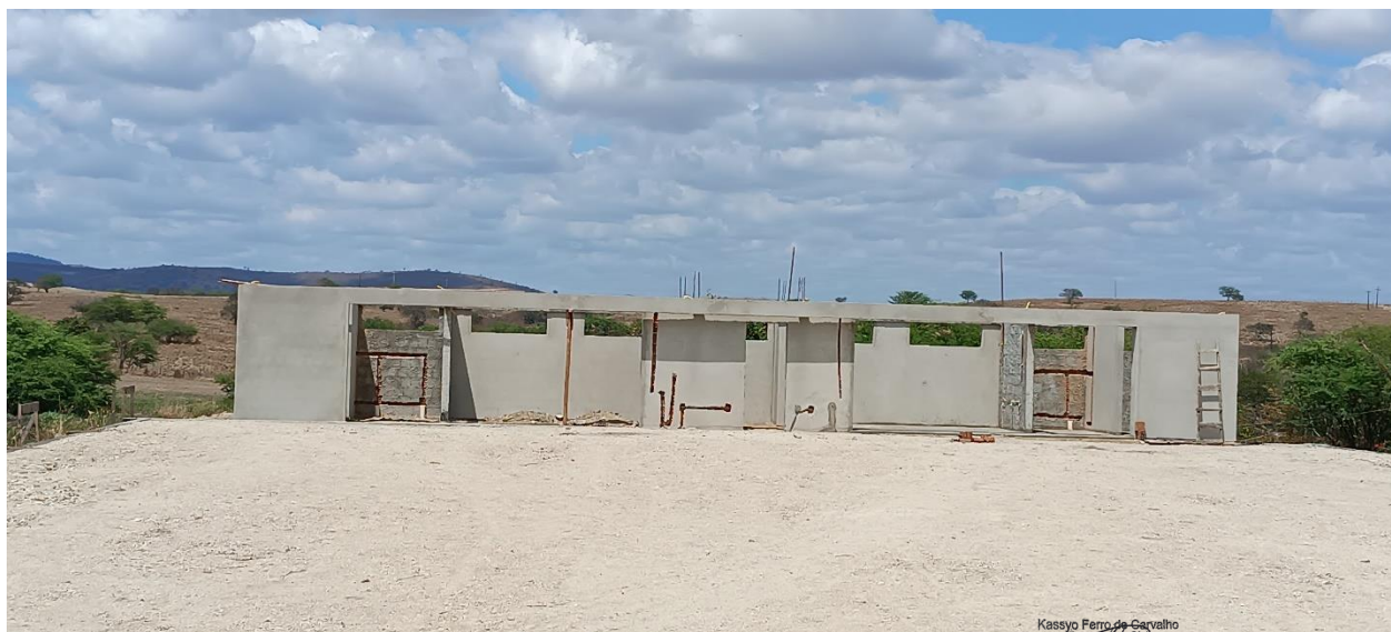
Figura 8: Rasgos na alvenaria das tubulações hidráulicas
