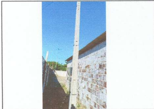
IMAGEM 03: Entrada de energia
