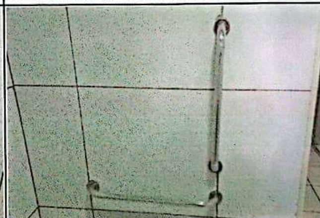
FOTO 04: Barras de apoio do banheiro PNE.
