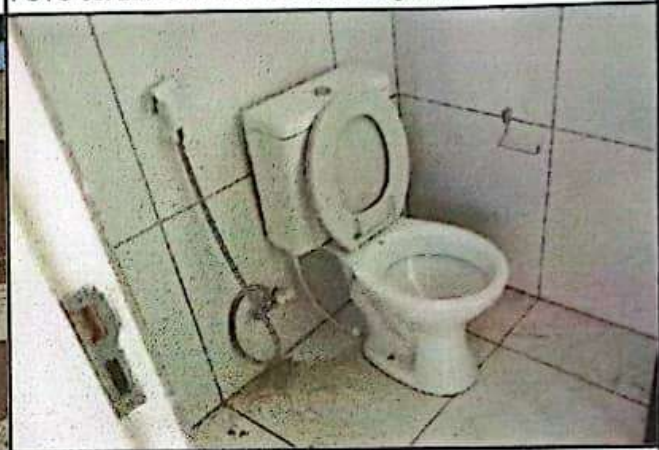
FOTO 10: Vaso sanitário para PCD.
