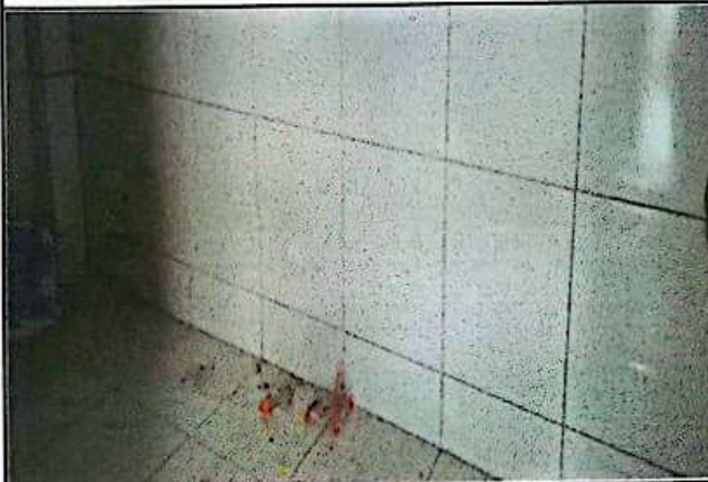
FOTO 03: Pontos de tomadas na sala de computação.
