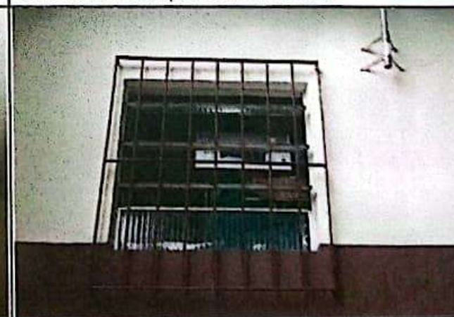
FOTO 06: Grade de proteção da janela.
