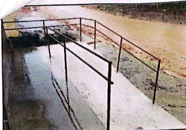
FOTO 07: Guarda corpo na entrada da escola.
