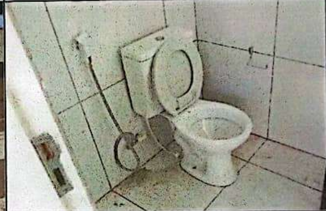
FOTO 10: Vaso sanitário para PCD.
