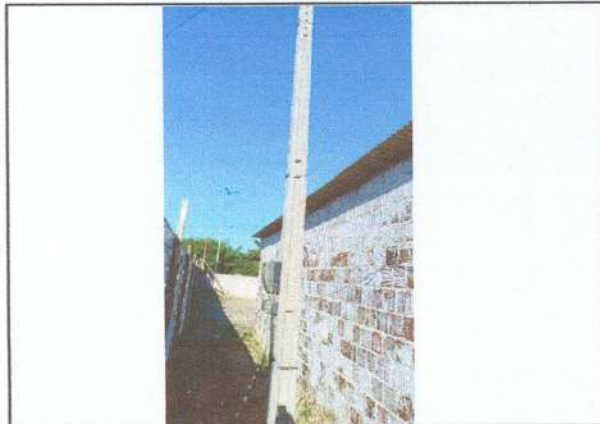
IMAGEM 03: Entrada de energia
