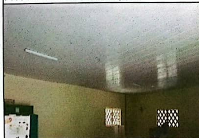
FOTO 05: Forro em regua de pvc da sala de aula.
