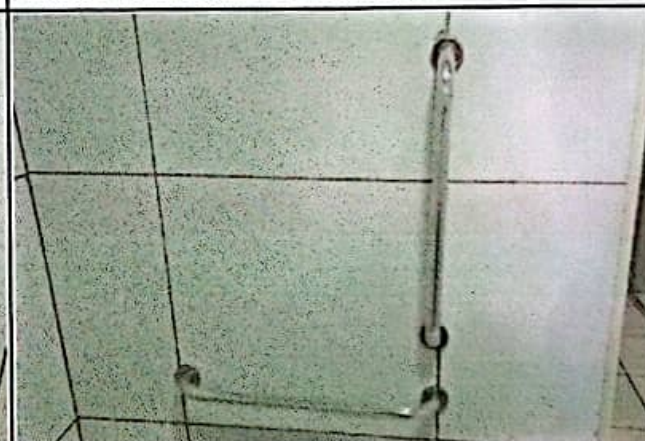
FOTO 04: Barras de apoio do banheiro PNE.
