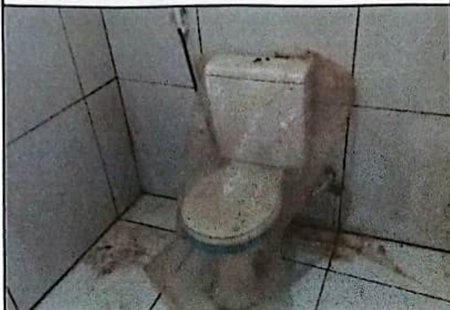
FOTO 01: Vaso Sanitario PCD.
