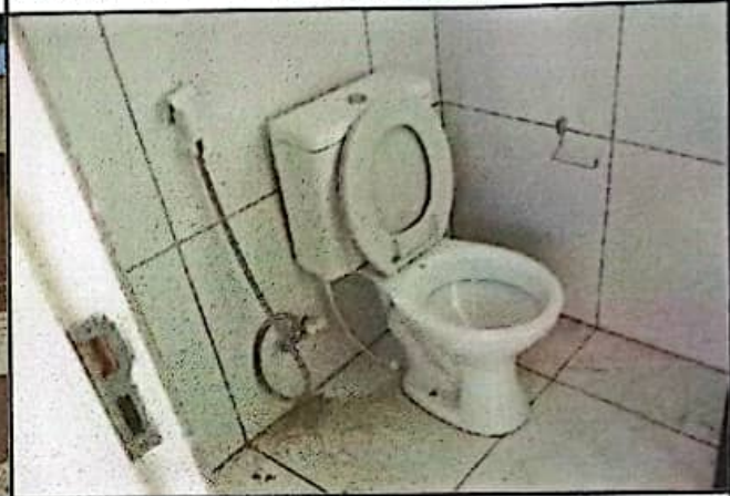
FOTO 10: Vaso sanitário para PCD.
