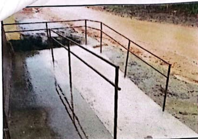
FOTO 07: Guarda corpo na entrada da escola.
