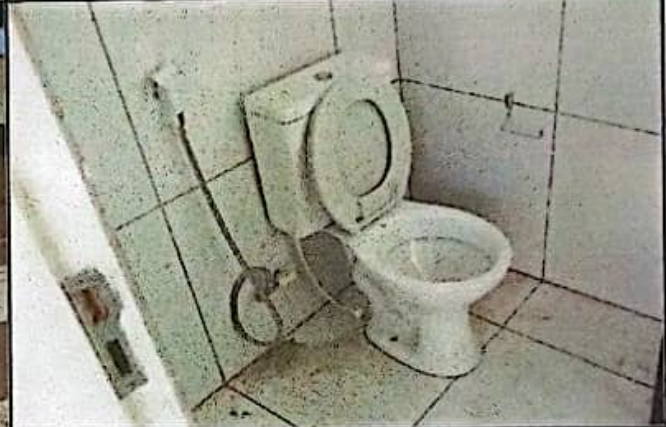
FOTO 10: Vaso sanitário para PCD.
