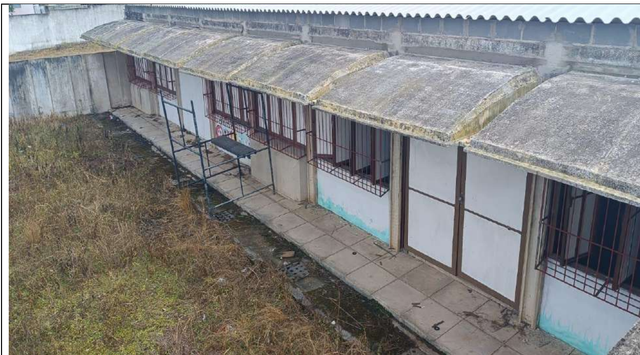
FOTO 05: GRADE DE PROTEÇÃO EM JANELA
