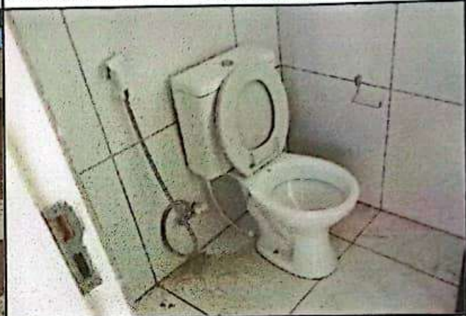
FOTO 10: Vaso sanitário para PCD.
