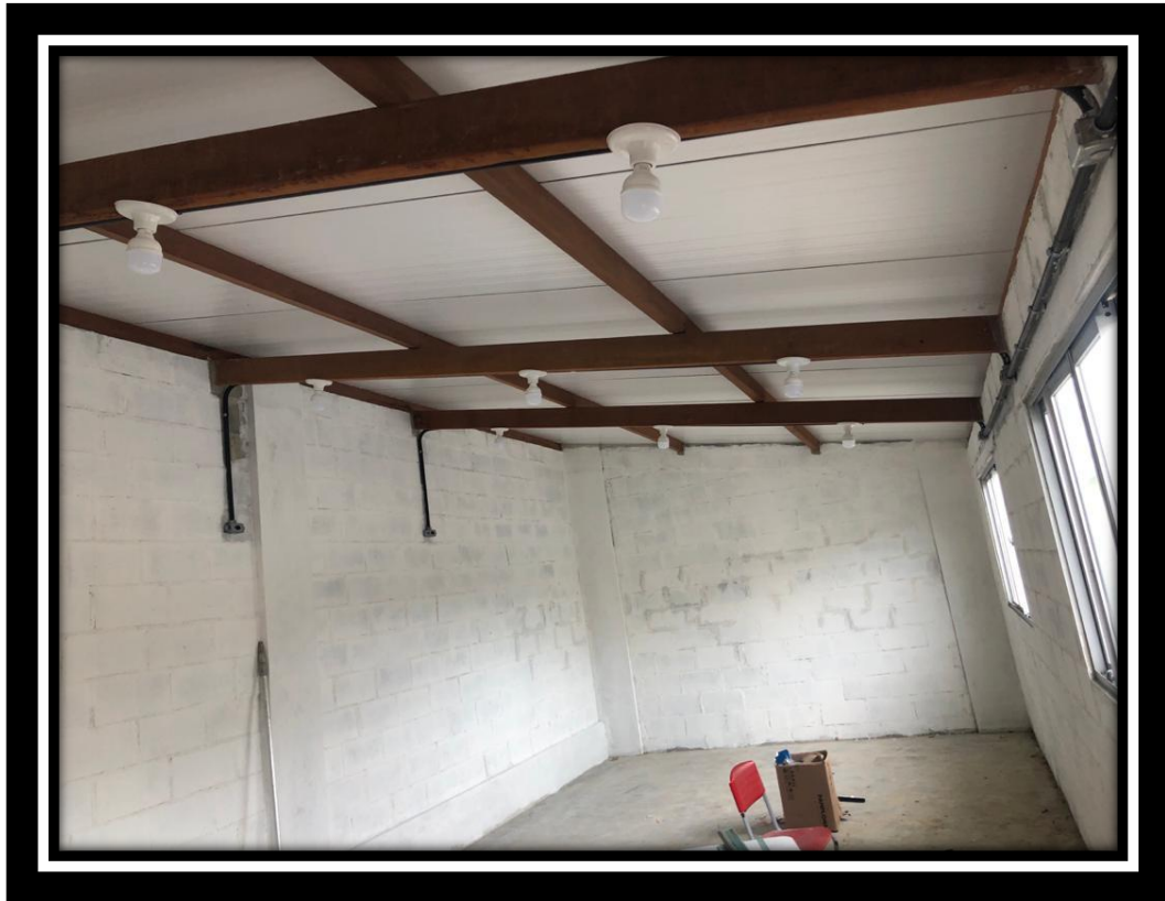
Foto 65 – Instalação elétrica de sobrepôr estilo industrial (Escola Maria Alice)
