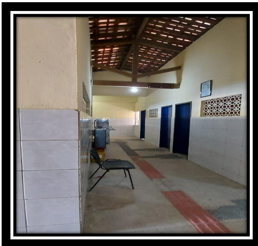
Foto 51 - Revestimento do piso em cerâmica e forro de PVC que não foram iniciados (Escola Adalgisa)
