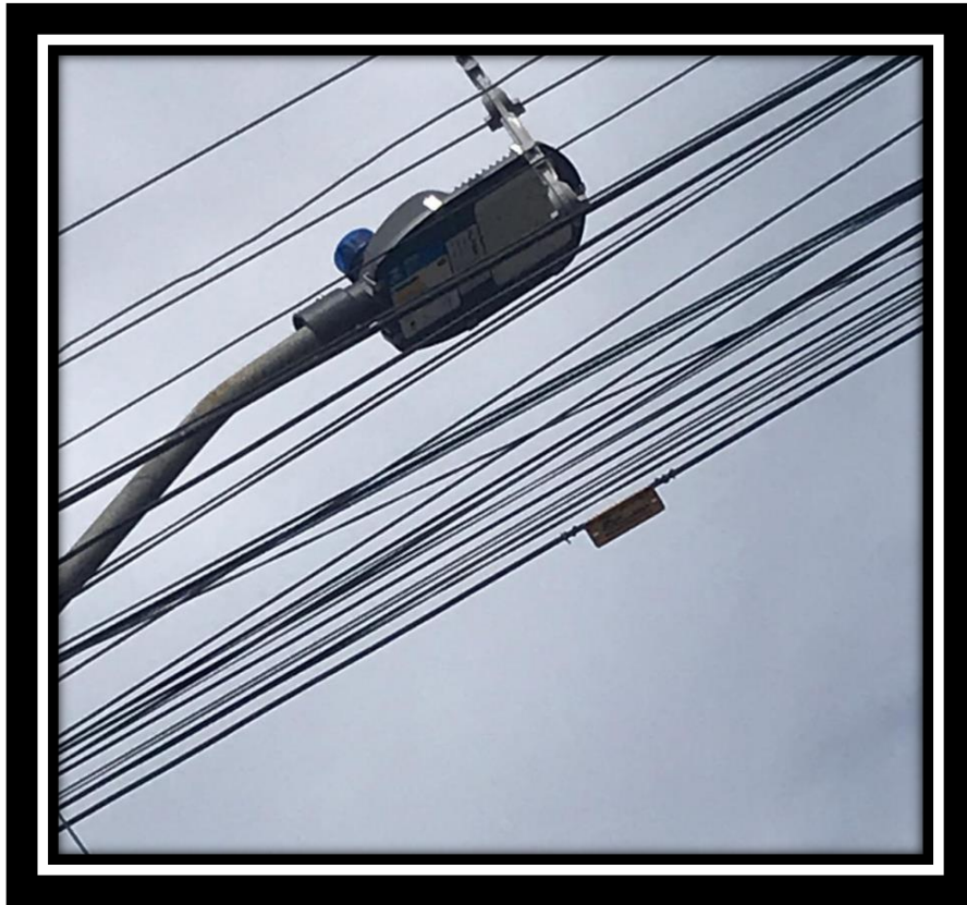
Foto 68 – Poste com implantação da iluminação em LED
